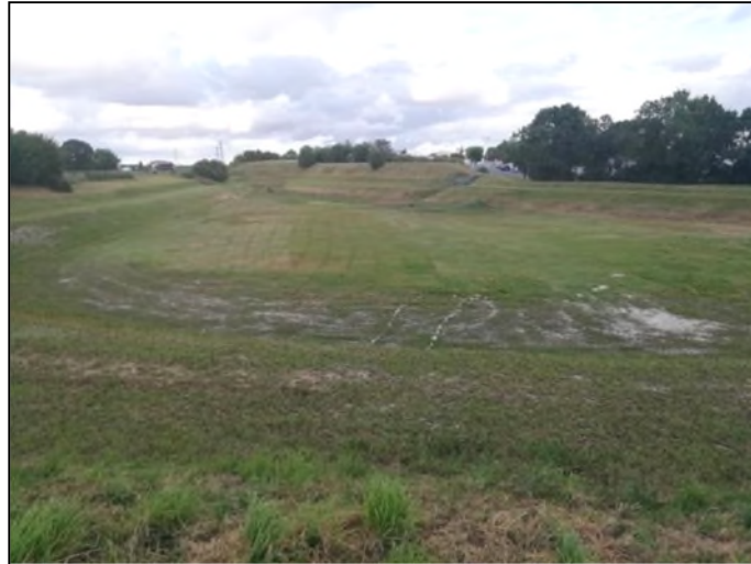
Photo 16 : Humidité non homogène au sein du bassin routier de rétention (N237 Puilboreau)
