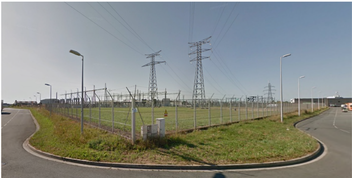
Photo 6 : Le poste électrique de transformation 225 000 / 90 000 volts de Beaulieu
