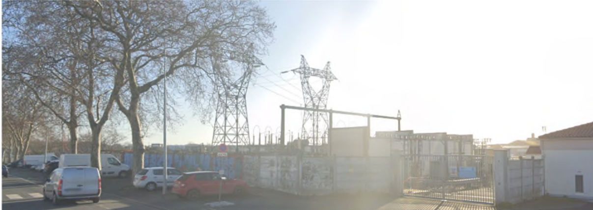
Photo 5 : Poste électrique 90 000 / 20 000 volts de La Pallice
