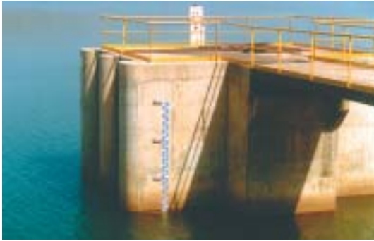
Photo 1. Échelle limnimétrique installée sur une tour de prise (barrage de Douma, Burkina Faso).
