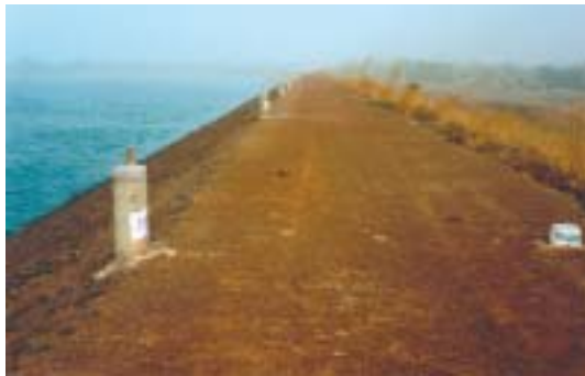
Photo 6. Protection de tête sur une ligne de piézomètres (remarquer également la borne pour le suivi topographique) (barrage de Douma, Burkina Faso).
