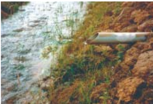
Photo 3. Exutoire d'un drain permettant des mesures par empotement depuis le fossé de pied (barrage de Douma, Burkina Faso).
