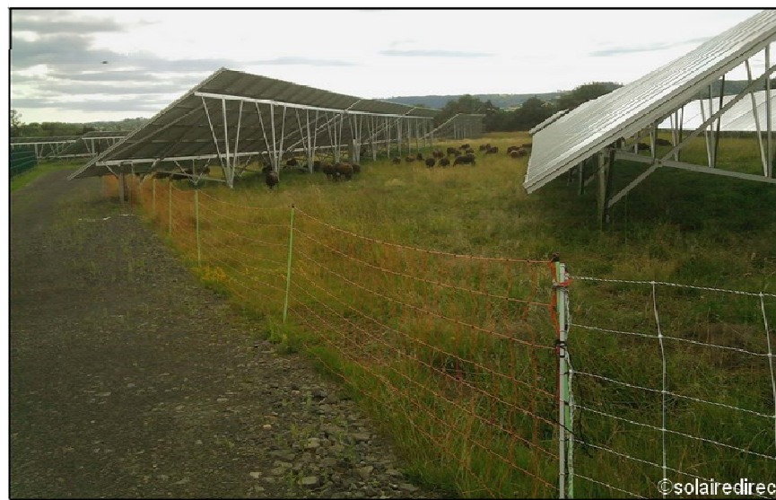
PARC SOLAIREDIRECT DE COUTEUGES (43).
