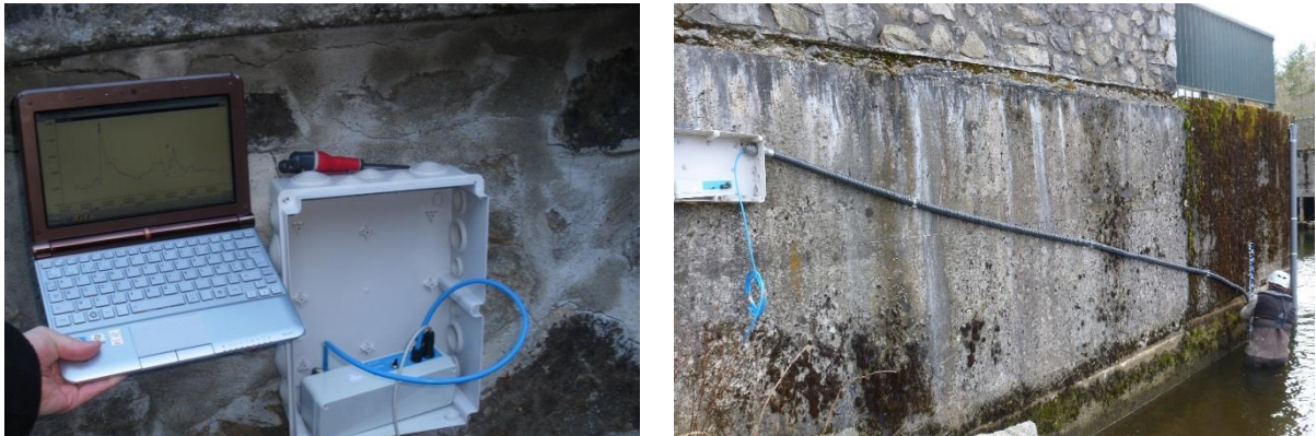
Figure 3 : Capteur de niveau d'eau de la station sortie Lac (à droite) / déchargement de l'enregistreur (à gauche) (Source : ATHOS Environnement)
