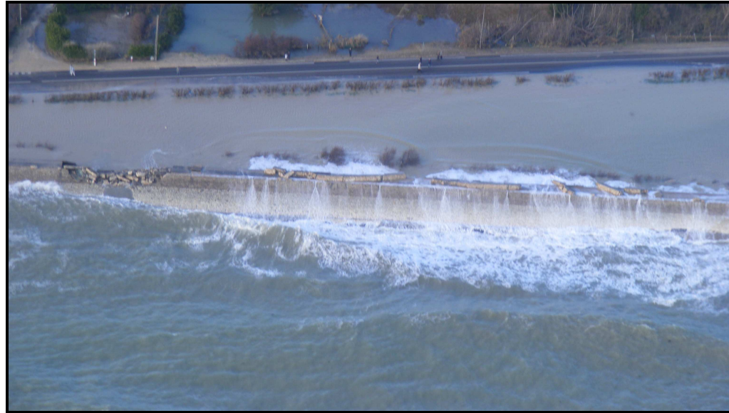
Figure 5 - Submersion de la digue de Matray par rupture de la protection
