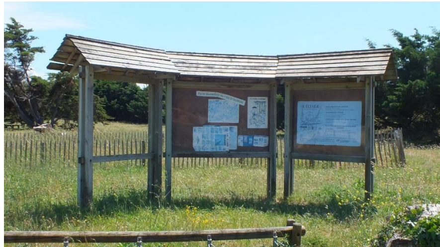
Triptyque toit double pente pour affichage divers : obsolète et cassé
