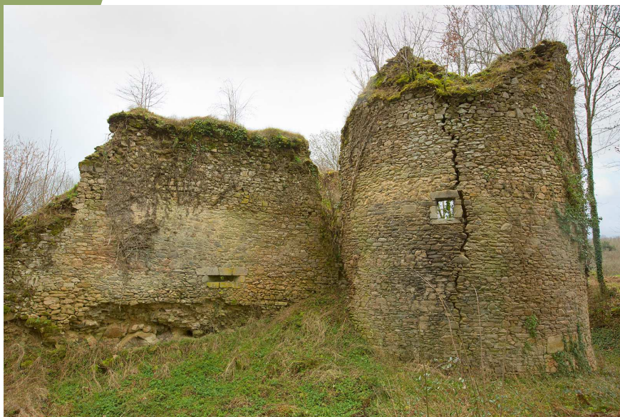
Tour d'angle en grand danger
