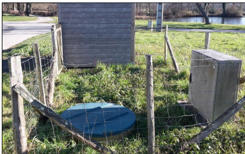
Photo 7 : Poste de relevage de Puygibaud
