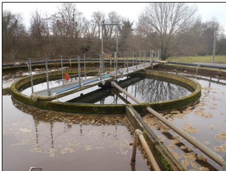
Photo 1 : Station d'épuration du Puymaud
