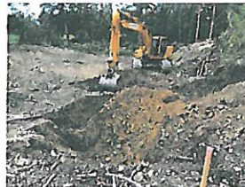
Purge et remblayage dans l'axe du niveau - 10 (comprenant les montages M1 et M2)
