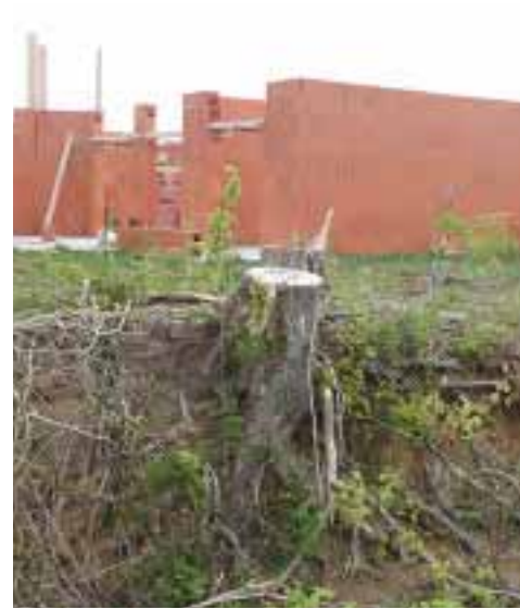
Haie bocagère fâcheusement abattue lors de travaux de construction d'un lotissement
