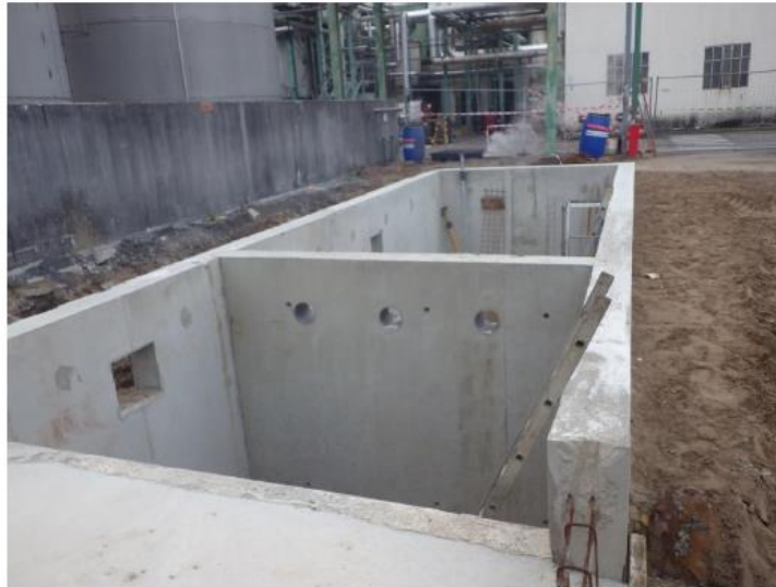
Bassin de sécurité à l'Isomérisation sur DRT VSG
