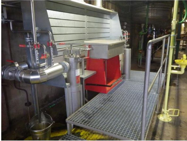
Nettoyage des filtres à Dertophènes (Protection collective)
