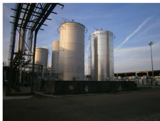
Générateur Vapeur et stockage de co-produits
