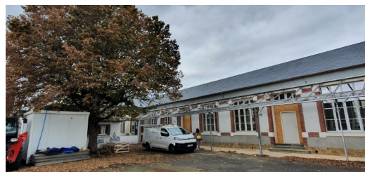
Résidence Gassiot à Pau Accessibilité avec Ascenseur extérieur et Façade arrière « galerie béarnaise »
