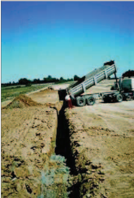
◀ 2 - Drain vertical recreusé dans le remblai et remplissage par du sable drainant et autofiltrant (texte p. 78).
