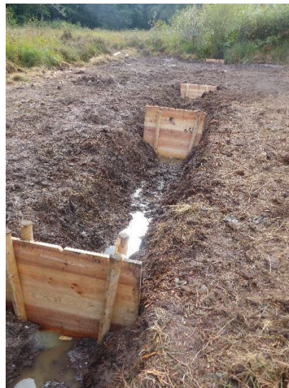
Comblement et réduction des écoulements par pose de batardeaux, d'un fossé de drainage dans une lande humide à Mazerolles (64)- Cette opération de restauration a été réalisée conformément à la loi sur l'eau après accord de la DDTM et de l'ONEMA. Photo : Gilles Bailleux - CEN Aquitaine
