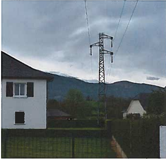
Pylône n°17 dans le lotissement à Buzy
