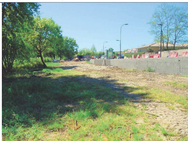
6 : Vue sur la partie Nord du site : travaux de la voirie de l'avenue de la Belle Etoile (04/2017)
