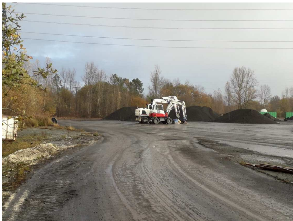
Photographie n° 6 : Vue sur la zone Ouest de la plateforme (COLAS SO, 03/12/2018)
