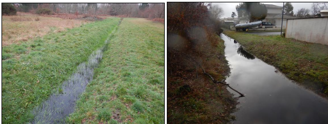
Figure 1 : Prises de vue représentant deux des fossés présents sur site (source : Envolis)
