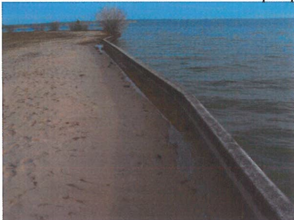
Muret de soutien de la plage artificielle voisine : les points bas semblent être créés par infiltrations de sous le muret
