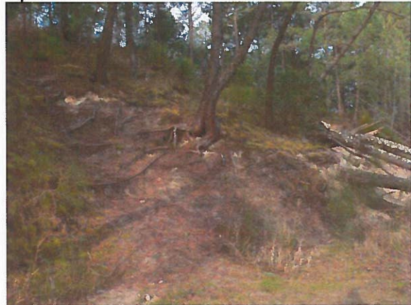
Talus en glissement côté nord de la plage artificielle
