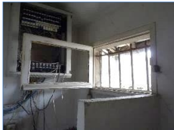
Vue sur une fenêtre laissée ouverte à l'étage du bâtiment n°8 – A. Liger, Écosphère
