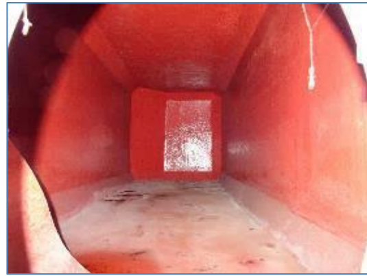
Vue de l'intérieur d'une des anciennes cuves à vin, non favorable aux chiroptères (parois complètement lisses) – A. Liger, Écosphère
