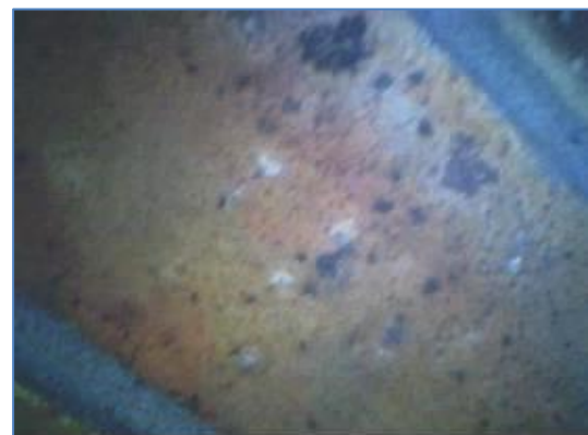
Observation à l'aide de l'endoscope de l'espace au niveau d'un faux-plafond du bâtiment n°3 – A. Liger, Écosphère
