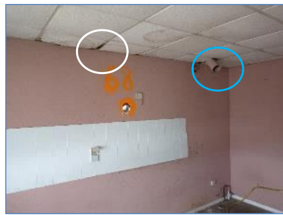
Interstice entre deux plaques du plafond (cercle blanc) et tuyau de ventilation (cercle bleu) potentiellement favorable au gîte de chiroptères – A. Liger, Écosphère
