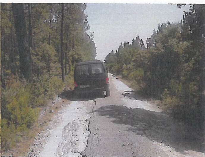
Devers de chaussée dangereux
