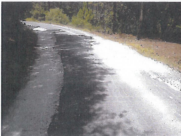
Chaussée revêtue dégradée
