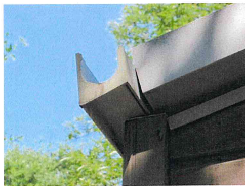
Gouttière sans descente d'eau, la pluie s'infiltré directement au pied de chaque mobil-home
