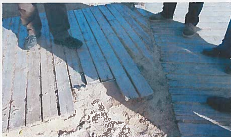
Le platelage Bois est également défectueux par endroit
