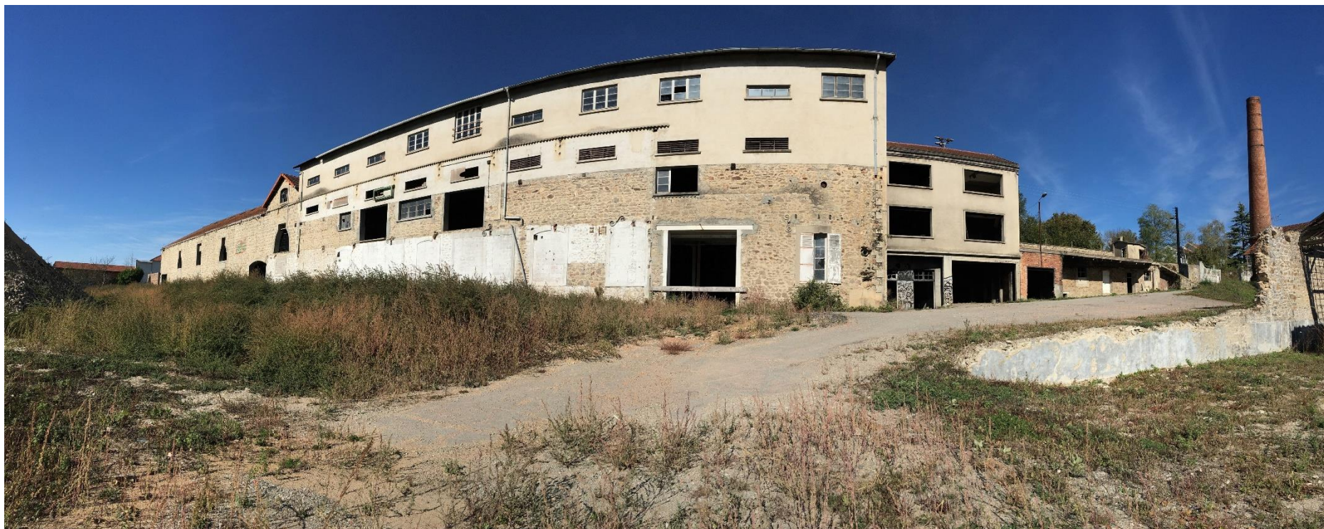
Photographie 2 : prise depuis le Sud de parcelle, vue panoramique du bâtiment à réhabiliter :
