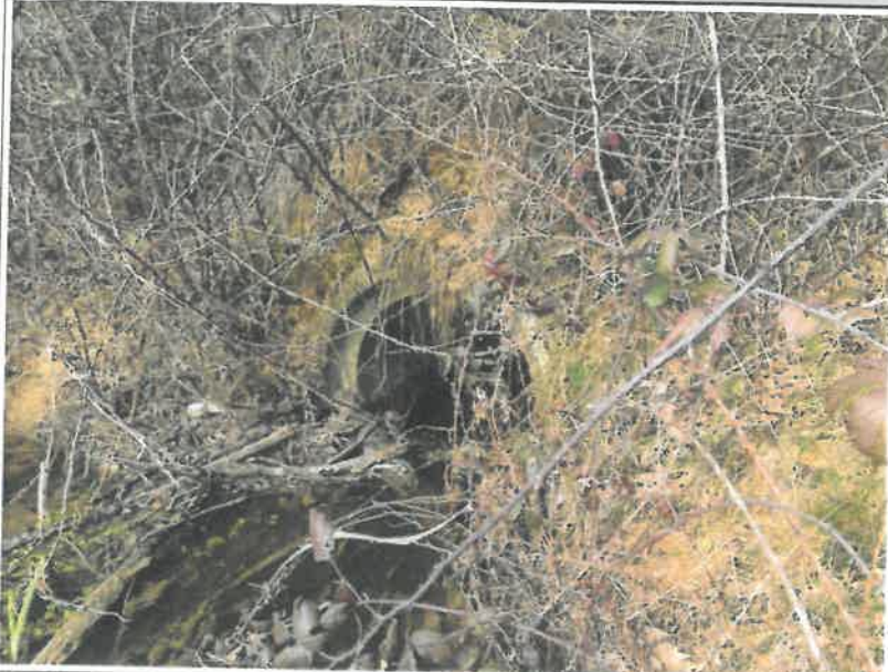
Photographie 4 Partie amont de la buse bétonnée qui sert d'évacuateur de crue (présence de ronces aux abords)
