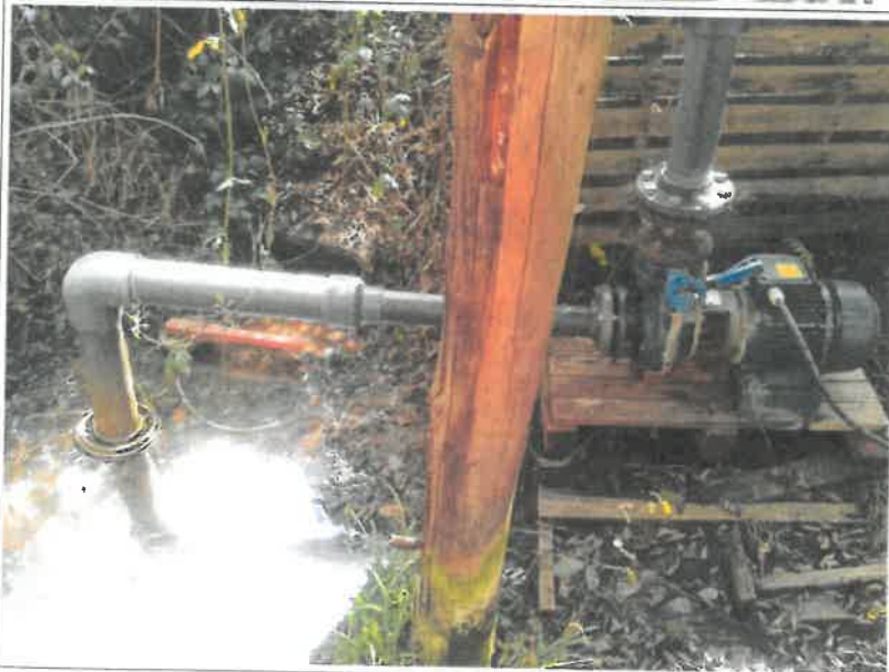
Photographie 6 Pompe reliée à la conduite de fond. (la vanne de la conduite de fond est en partie immergée du fait d'eau stagnante à cet endroit)
