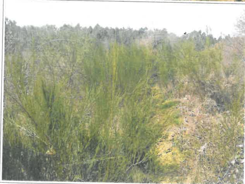
Photographie 3 Détail de la végétation ligneuse qui a colonisé les parements du barrage
