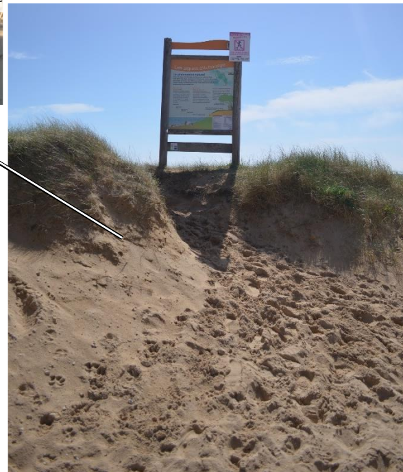
Effondrement de la dune notamment dû à la présence du panneau nécessitant un piétinement pour lecture.
