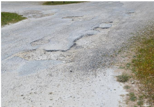
Voie de circulation déformée et parsemée de nids de poules
