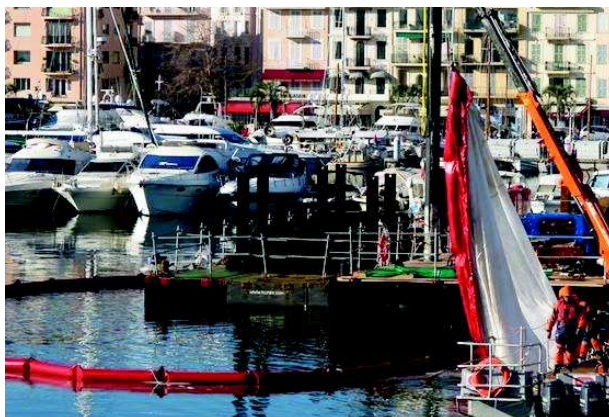
Mise en place barrage-barrière filtrant MES pour travaux maritimes BTM- port de CANNES
