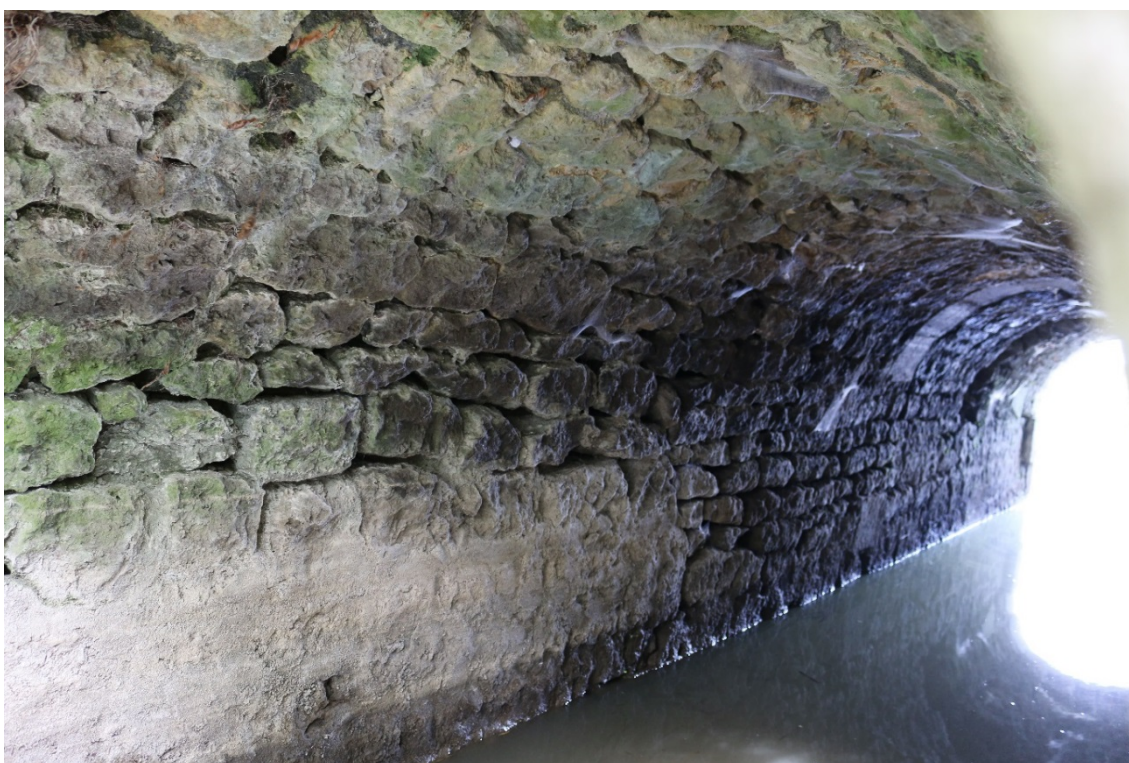
Photo 2 : Disjointements entre les pierres du pont favorables aux chiroptères
