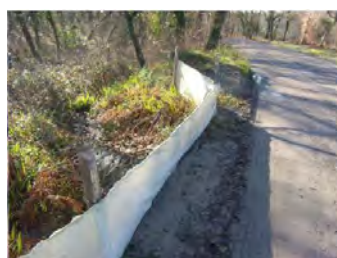
Figure 47 : Barrières filtrantes (NGE-Guintoli)
