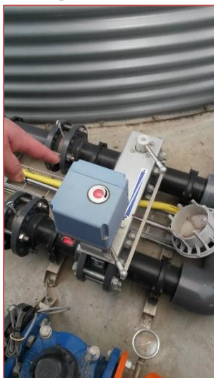
Module automatisé (répartition eau traitée / eau propre)
