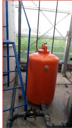
Filtre à sable
