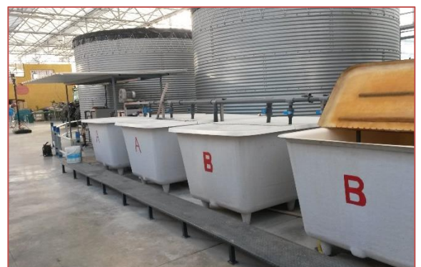
Cuve de mélange pour la préparation des solutions d'intrants (en premier plan) et cuve de stockage eau propre et eau traitée (en arrière-plan)
