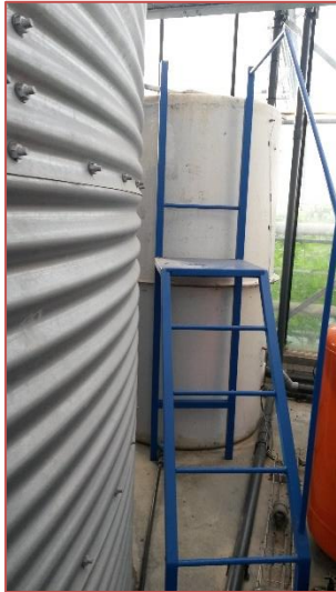
Cuve de stockage d'eau sale avec dégrilleur en entrée
