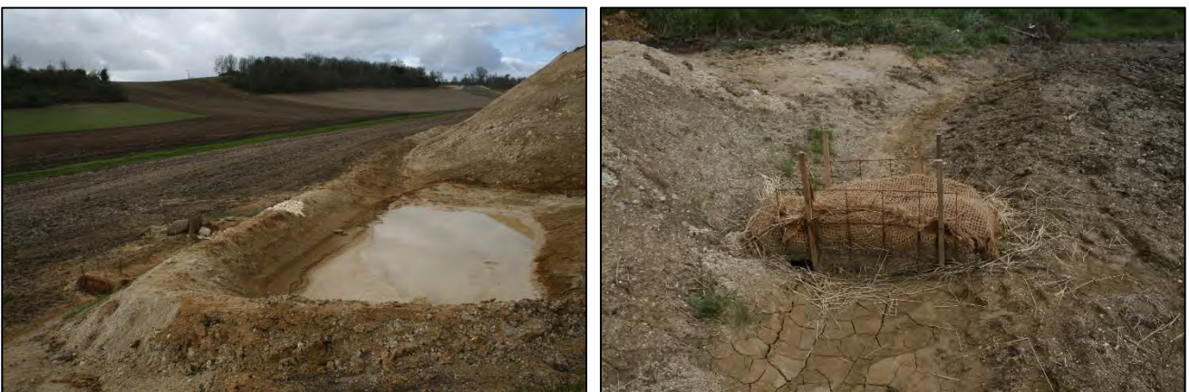
Figure 5 : bassin de décantation temporaire des eaux de ruissellement en phase de chantier avec filtre à paille en sortie
