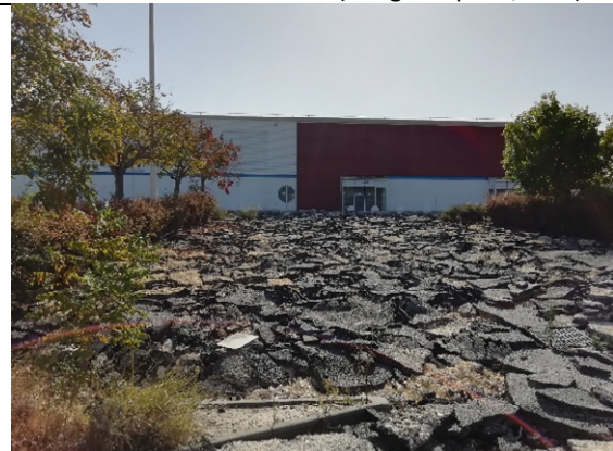
5 : Secteur Ouest : parking principal (enrobé détruit) (09/2019)
