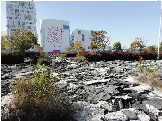
4 : Secteur Ouest : parking principal (enrobé détruit) (09/2019)
