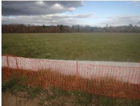
Filet de protection temporaire et filet de chantier
