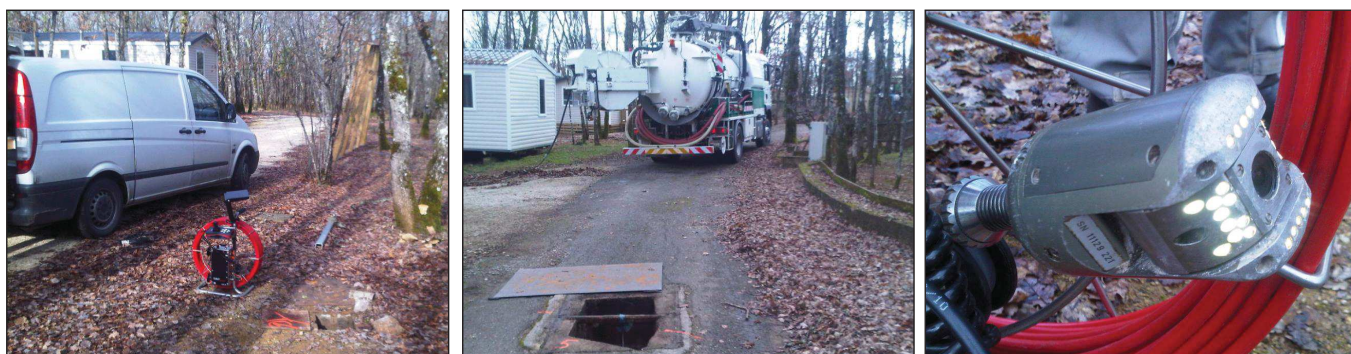
Illustrations photographiques de l'inspection du réseau réalisée sur le site du camping LOU CASTEL
