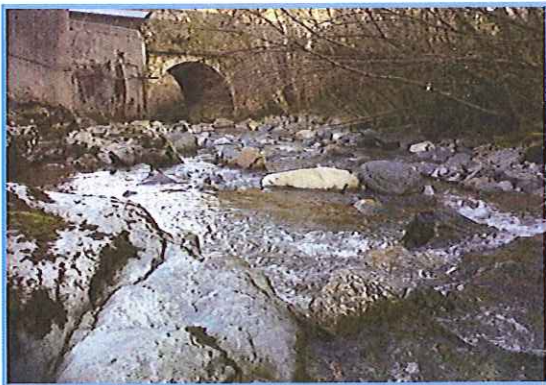
Vue générale de la station (depuis l'amont)
