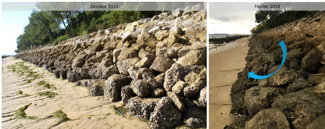
Figure 13: Glissement des ouvrages vers le bassin constaté entre 2010 et 2018 (source : BEFES, 2018)
