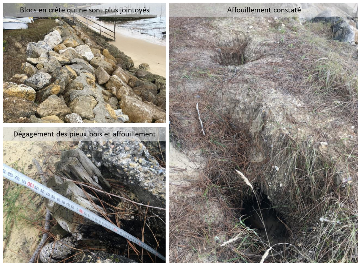
Figure 12: Désordres observés par BEFES lors de la visite de site de 2018 (source : BEFES, 2018)
