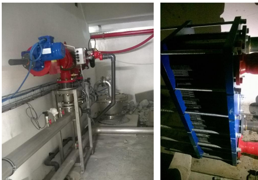
Figure 3 – Puits géothermique avec son système de filtration et l'échangeur thermique
