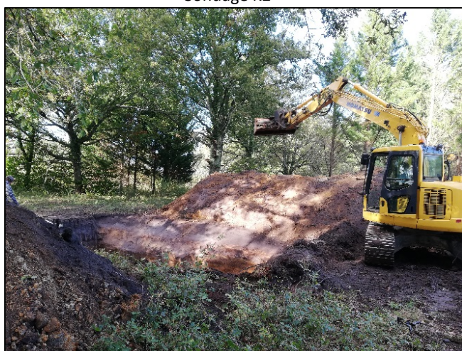
Fouille à la pelle réalisée le jour des investigations au droit de la zone d'implantation pressentie
