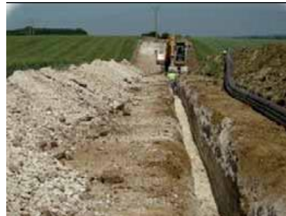
Illustration 10 : Réalisation de la tranchée puis déroulage des fourreaux PEHD le long de la fouille avant de les descendre
