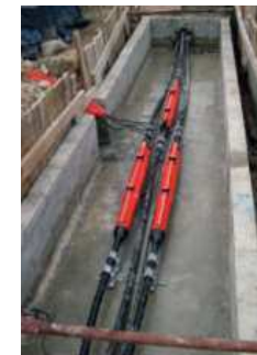
Figure 6 : Exemple de chambre de jonction
