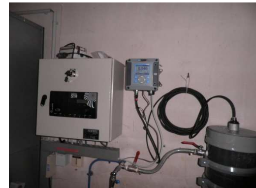
Turbidimètre télégré situé dans la station de pompage de la Fontaine de Maillé
