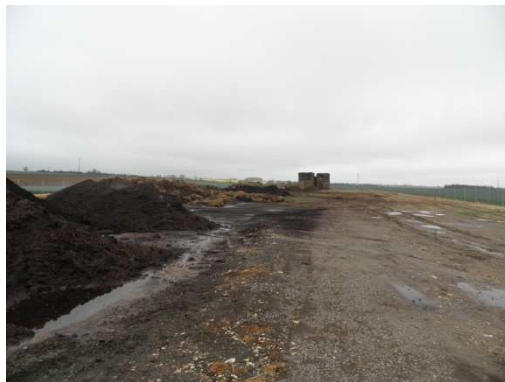
Stockage de fumier, de compost et de paille sans plateforme imperméable et système de récupération des jus situé dans le périmètre de protection éloignée
