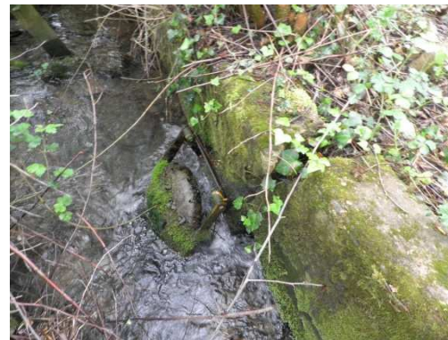
Trop-plein de la source de la Fontaine de Maillé avec clapet anti-retour se jetant dans la Vendelogne au sud du captage
