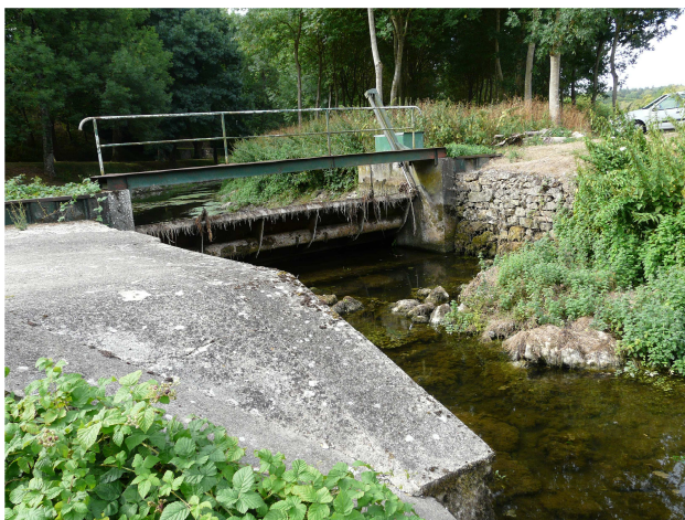
Figure 1 : Clapet de moulin en position haute limitant les flux, sur le bassin du Clain
