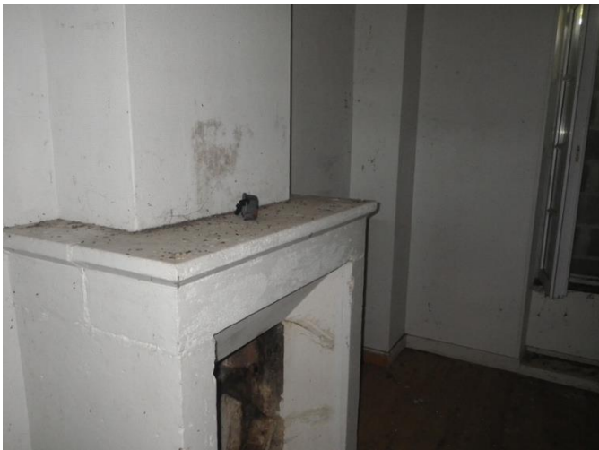
Photo. 5 : vue du Batlogger au point pièce ET3 (SCE, 25/09/2023)
