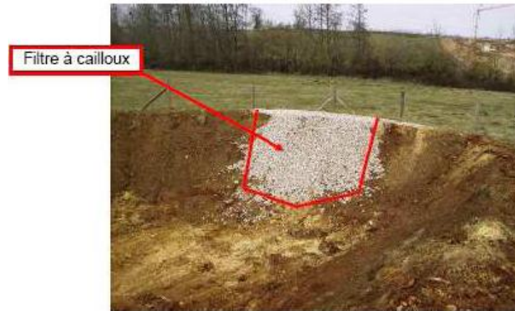
Filtre à cailloux
