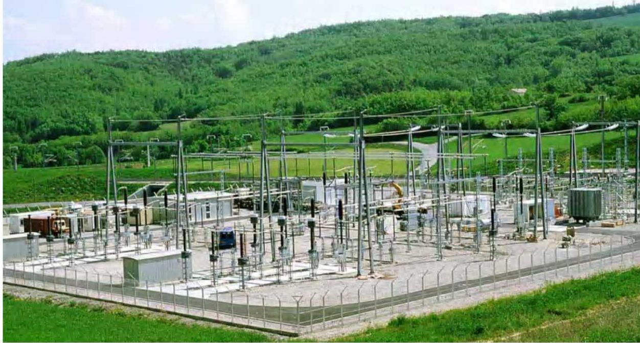
Figure 28 - Exemple de sous-station électrique
