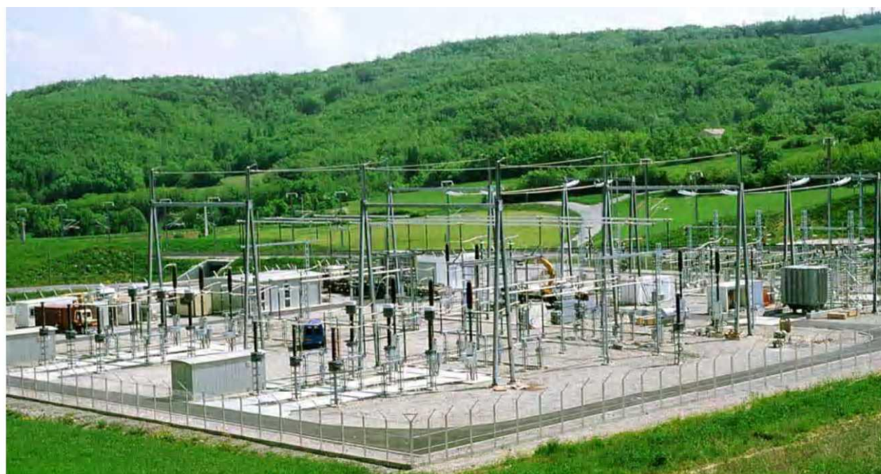
Figure 28 - Exemple de sous-station électrique
