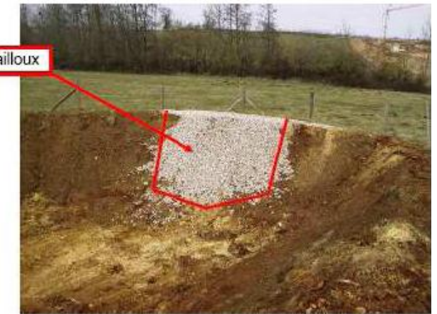
Filtre à cailloux
