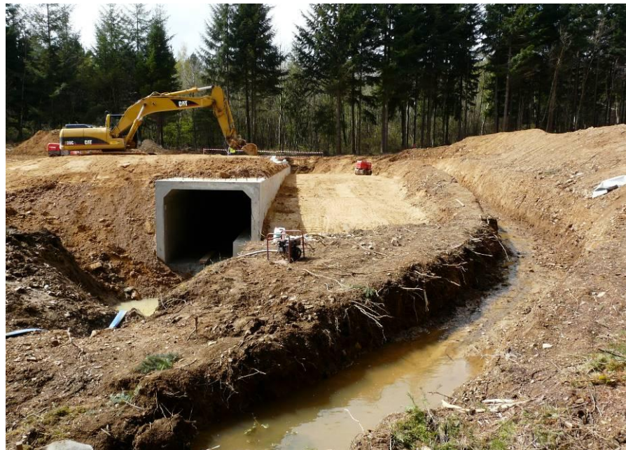
Figure 60 – Exemple de dérivation provisoire permettant de réaliser l'ouvrage définitif à sec (A88)
