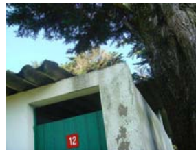
Toiture en Fibro Ciment et très dégradée
