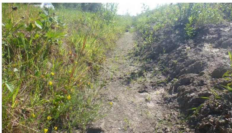
Figure 10 : Vue du fossé à l'endroit colmaté par ruissellement de boue provenant du site (Source : Simethis)
