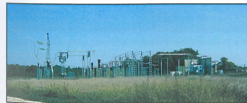
Photo d'un poste de même type que le poste de Peyrilhac (sans aménagement paysager)
