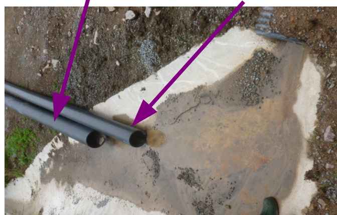
Arrivée des 2 drains à l'entrée de la galerie TB100
